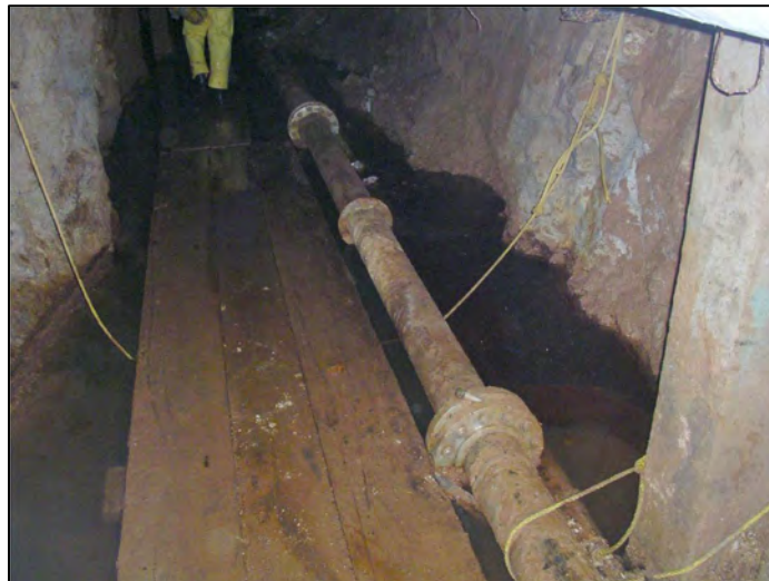
STAINLESS STEEL PIPE STA 6+39 TO STA 6+50 (2001)
